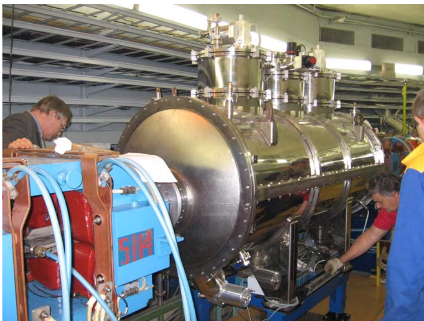
Рис. 48. Монтаж 21-полюсного сверхпроводящего вигглера с полем 7.7 Тесла и периодом 164 мм на накопителе «Сибирь-2».
